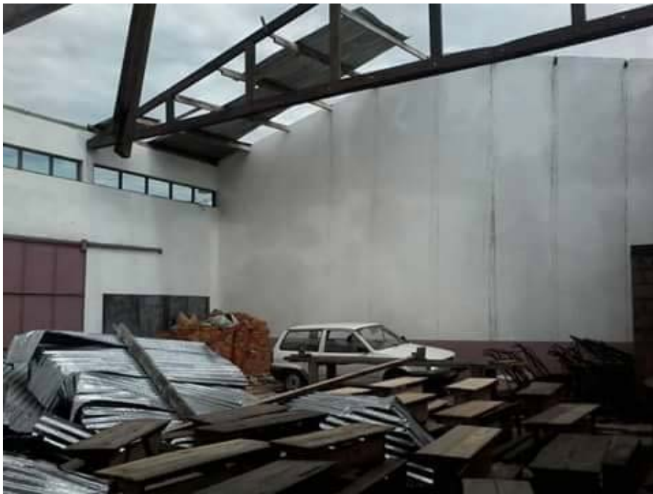
Figure 2 : Bâtiment A après le passage du cyclone
